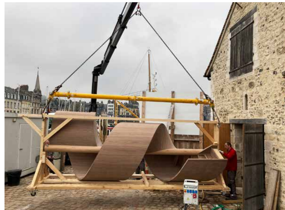
Arrivée de l'escalier d'un seul tenant, installation à l'aide d'une grue dans la salle d'accueil du CIAP. © Entreprise Gesbert
