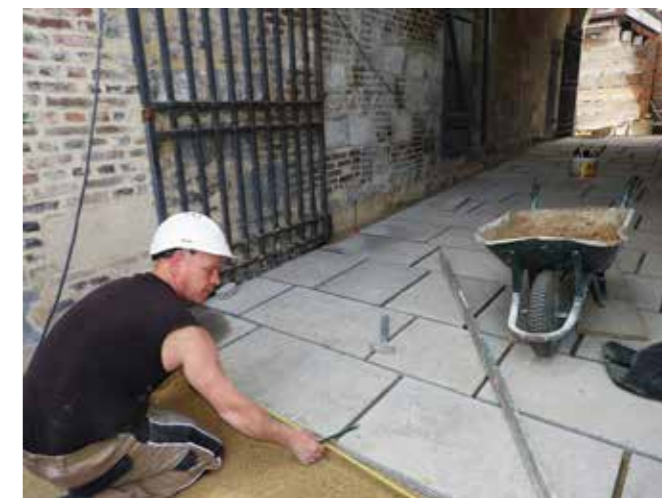
Pose d'un dallage extérieur en pierre naturelle dans le passage voûté de l'avant-porte. © Catherine Auger
